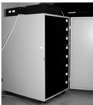
図 12 ECS 5.8 kWh 電力貯蔵システム (*8)
