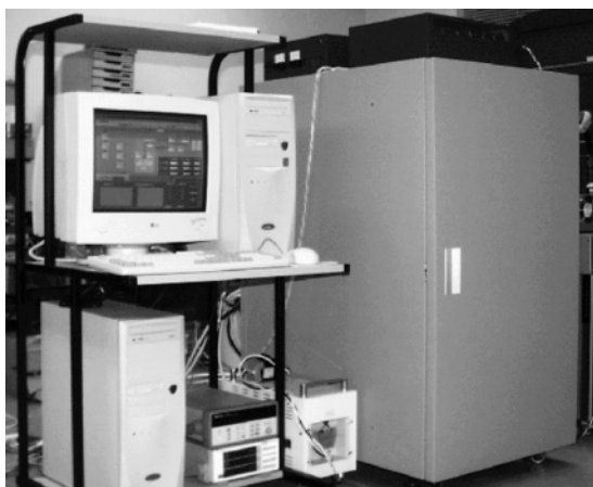
写真1-3 5.5 kW 負荷平準化用 ECS 電力貯蔵装置
