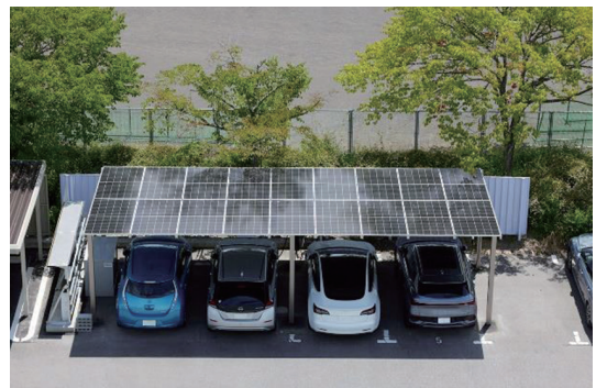
東大ベンチャー Yanekara の オフグリッド EV 充電設備
