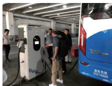
図9 EVバス充電器 (40KWx2/台)
