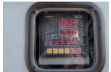
電源装置のメーター
