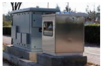
停留所近くにあった電源装置
